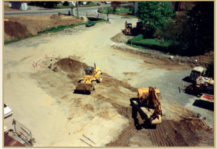
Zum Foto: Die Außenanlage des neuen Rathauses, die nahtlos in den Festplatz der Kärmetze übergeht, wird gerade mit Baggern und Raupen planiert.
